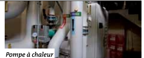
Pompe à chaleur
